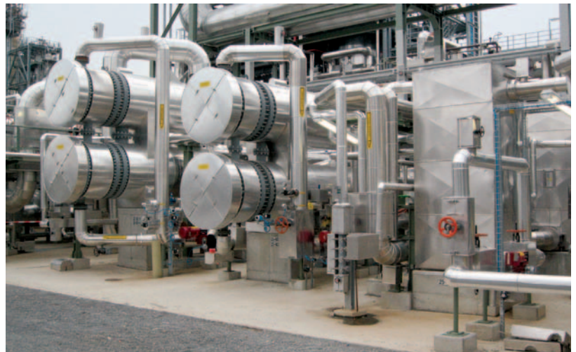
Wärmetauscher (4 Rohrbündel und 2 Platten) im MiRO-Werkteil 1
