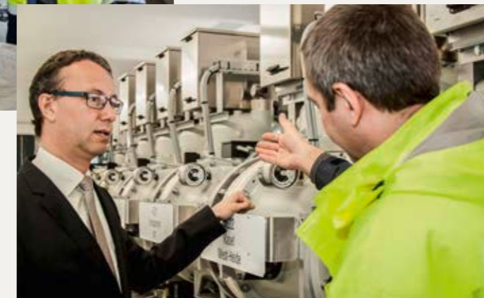
Dr. Markus Ulmer (links) war für die Modernisierung des Umspannwerks verantwortlich. Projektleiter war Achim Milbich.
