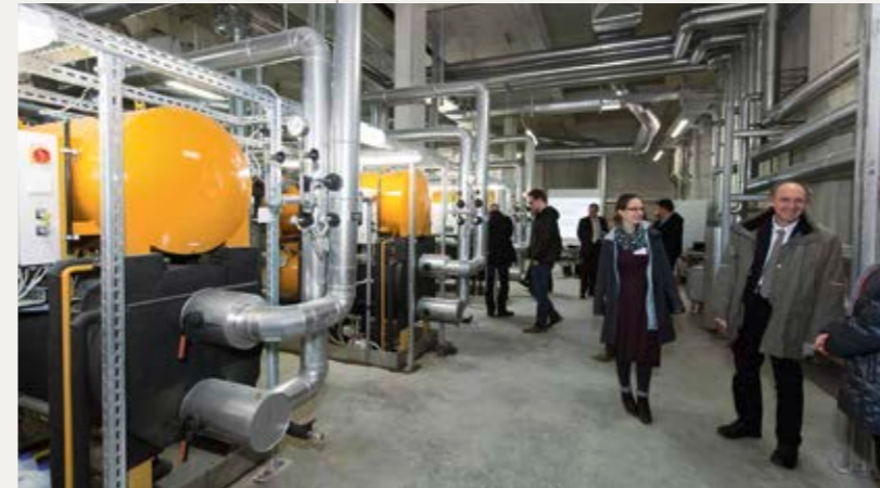
Die großen gelb-schwarzen Absorptions-Kälteanlagen im Keller des SYNUS-Gebäudes sparen 115 Tonnen CO 2 pro Jahr ein.
