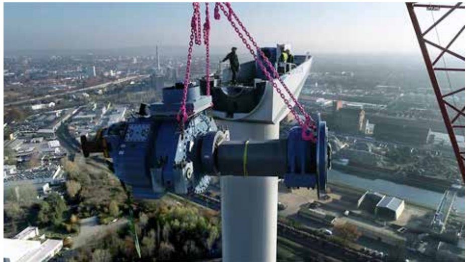
Aufbau von Tomasz Kulwickis Arbeitsplatz in 162 m Höhe auf dem Energieberg im Rheinhafen.
