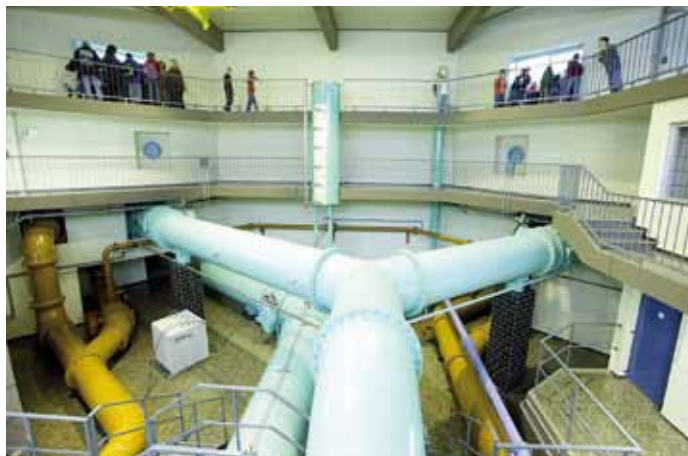
Wasserwerk Rheinwald: Rohrleitungen von und zu den Reinwasserbehältern
